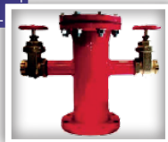
HIDRANTE TIPO PETROLERO
