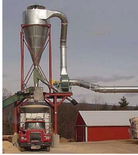
Ciclones como pre-filtros con descarga a transportes, silos o tolvas.
