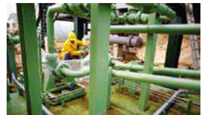
Tratamiento de agua
