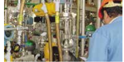
Medición y control
